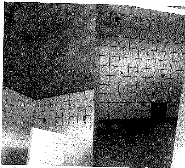
Imagem n° 09 (a esquerda): Vista da área de banho do vestiário. Detalhe para os elementos de elétrica e hidráulica já instalados. Imagem n° 10 (a direita): Revestimento cerâmico interno. Necessário substituir peças danificadas ou vandalizadas.
