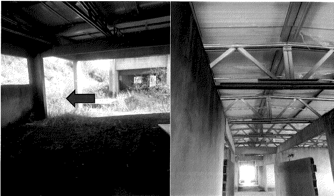
Imagem 05 – Vista interna da edificação com visão para a lateral do terreno. Necessário tratamento do talude para garantia de segurança.
